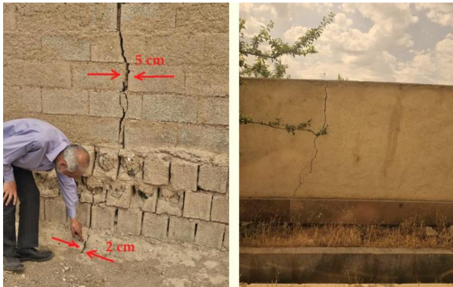
شکل ۳-۱۵- ترک خوردگی در دیوار بنای جدید ساز و دیوار و پی بنای قدیمی در اثر برداشت آب زیرزمینی در دشت هشتگرد
