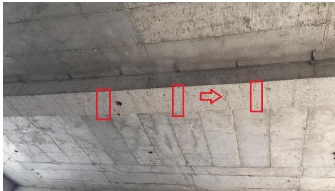
شکل ۳-۱۰- نمونه‌ای از ترک‌های خمشی در سطح زیرین عضو بتنی
