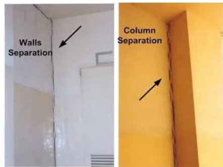
شکل ۳-۱۲- ترک‌های جداسدگی بین دیوار و اجزای دیگر
